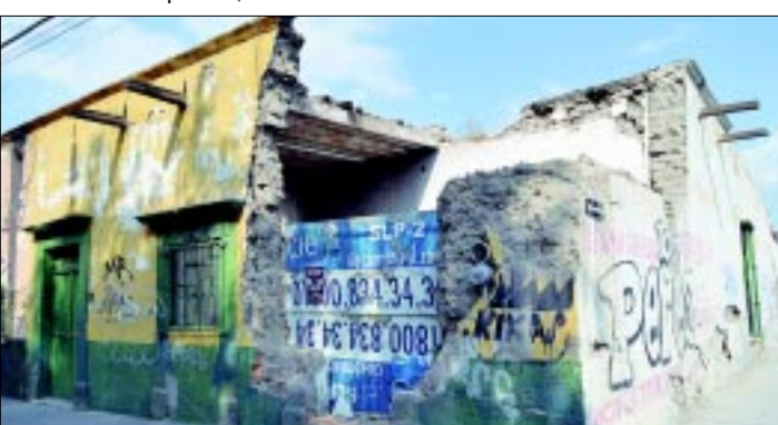
Protección Civil Municipal, aplica acciones preventivas para evitar riesgos de que las fincas antiguas pudieran devastarse durante la temporada de lluvias.
