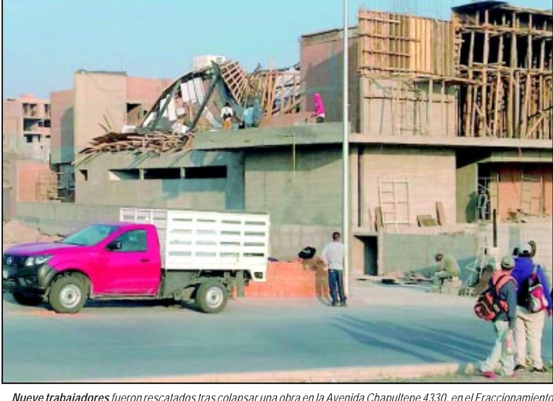
Nueve trabajadores fueron rescatados tras colapsar una obra en la Avenida Chapultepe 4330, en el Fraccionamiento Privadas del Pedregal, dos de los cuales resultaron con lesiones de consideración y los demás solo con golpes.
