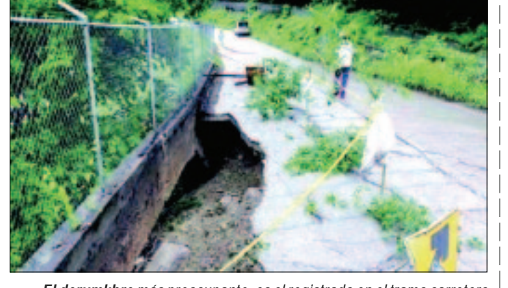
El derumbre más preocupante, es el registrado en el tramo carretero Ciudad Valles-El Naranjo
